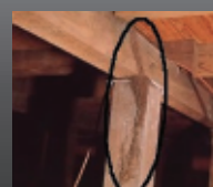
土台のカビ・腐食
